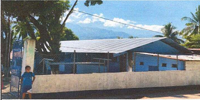
Foto1: Estado actual del techo exterior cubierto por láminas troqueladas calibre 26.
